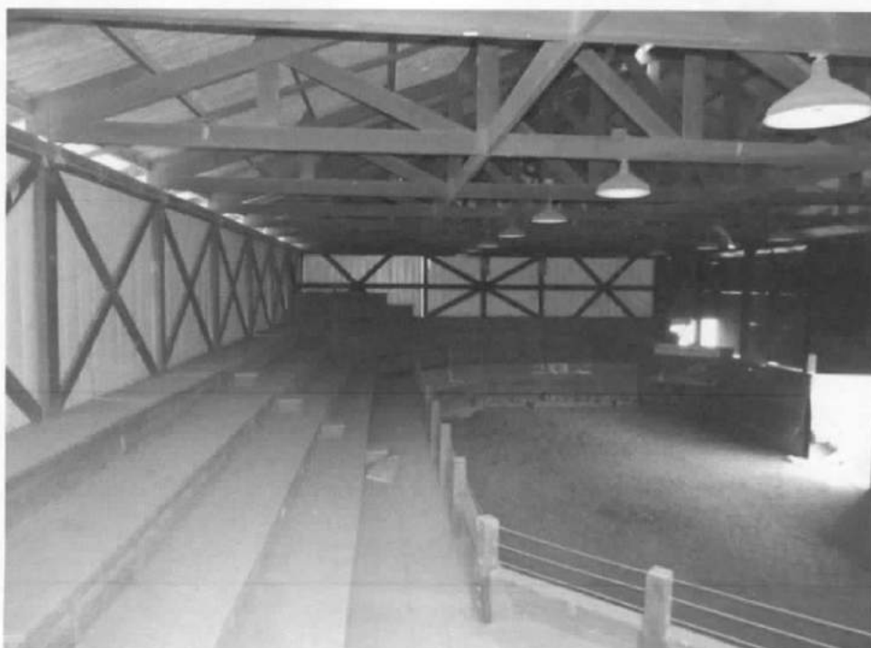
Galpão de Remates e Arquibancadas – item 6.4.5. do laudo: vista geral e vista interna.
